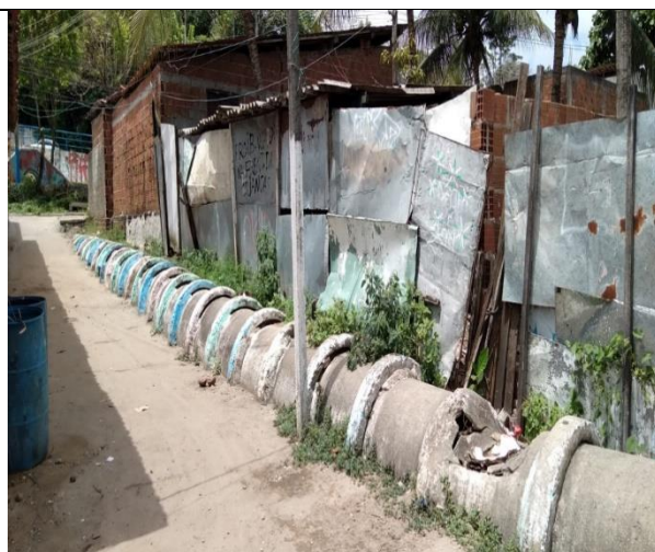
Imagem 4 Condição das habitações hoje, dividindo espaço com a tubulação de esgoto da CAGEPA, algumas delas edificadas, de forma precária em cima dessa tubulação. Fonte: Arquivo do pesquisador Data: 27/10/2021
